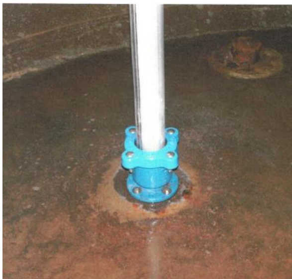
Flangesamling på råvandsrør ved i bunden af tanken
