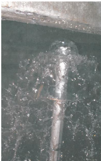
Iltning i vandtårnet over prelpladerne i drift. (udleveret billede fra udførelsen)
